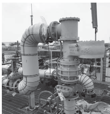
設置されたブリザーバルブ
